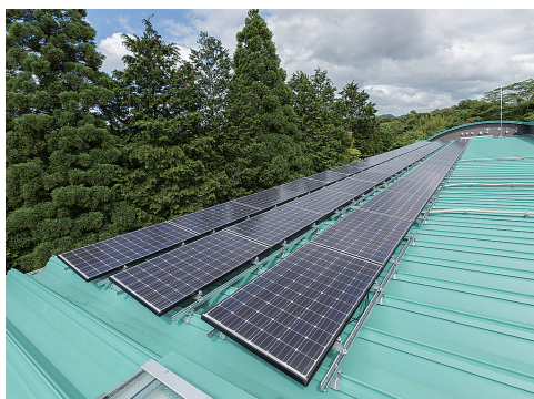
太陽光発電システム
