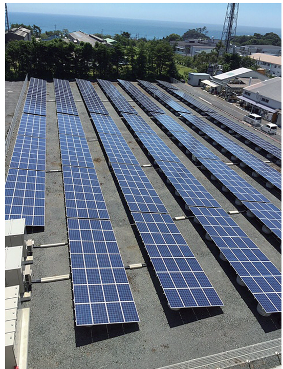
北茨城太陽光発電所
