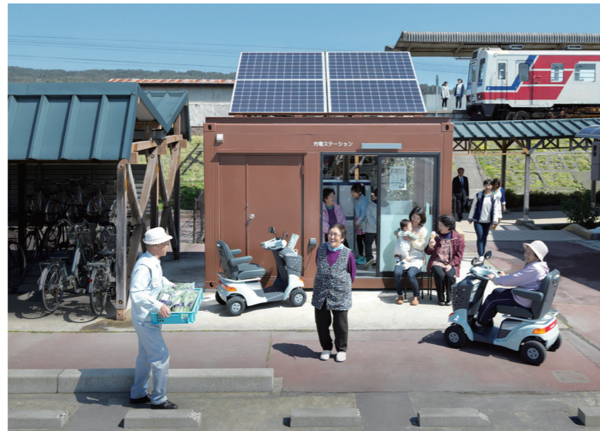
道の駅「のだ」に設置された充電ステーション。
